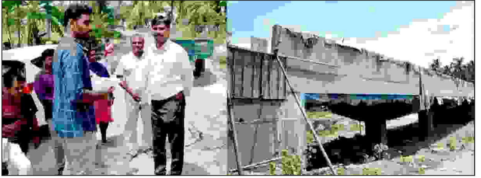
ஈரோடு மாவட்ட ஆட்சித்தலைவர் ச.கந்தசாமி நேற்று (9.06.2026) ஈரோடு மாவட்டம், அந்தியூர் ஊராட்சி ஒன்றியம், நகலூர் சாலையில் இருந்து கொண்டையம்பாளையம் செல்லும் சாலைப்பகுதியில் அமைக்கப்பட்டுள்ள கொண்டையம்பாளையம் ஒடைமீது சிறிய பாலம் அமைக்கும் பணியினை பார்வையிட்டு, ஆய்வு மேற்கொண்டார்.
